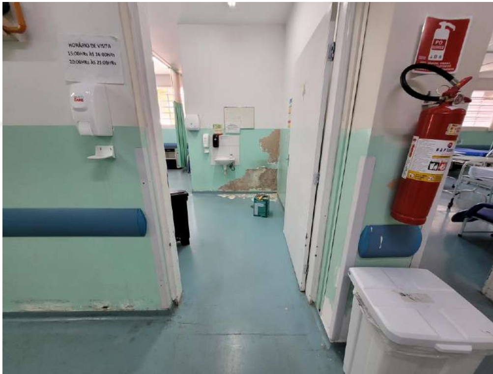
FOTO 7. Vista para a enfermaria masculina, com destacamento da parede.
