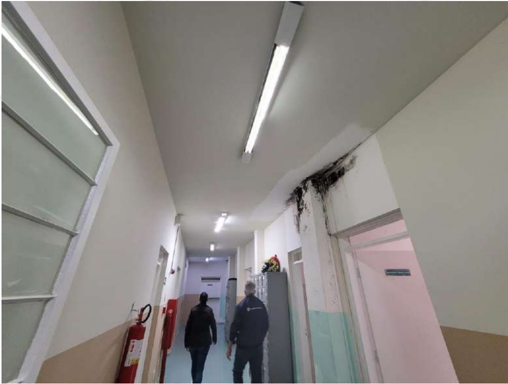
FOTO 1. Vista para o corredor dos sanitários dos funcionários, com manchas de bolor de infiltrações.
