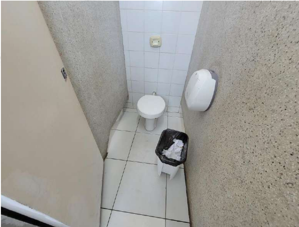
FOTO 49. Tudo de ligação do vaso sanitário com defeitos, causando infiltrações no acionamento.
