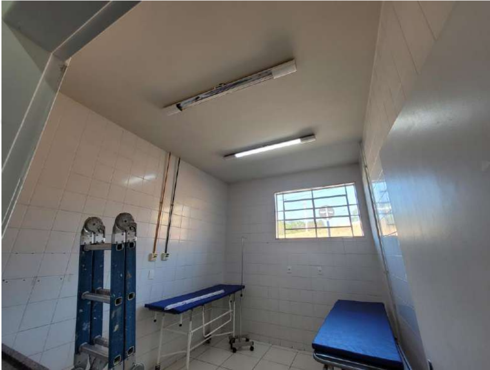
FOTO 15. Vista para a lâmpadas queimadas, sala de apoio a emergência.
