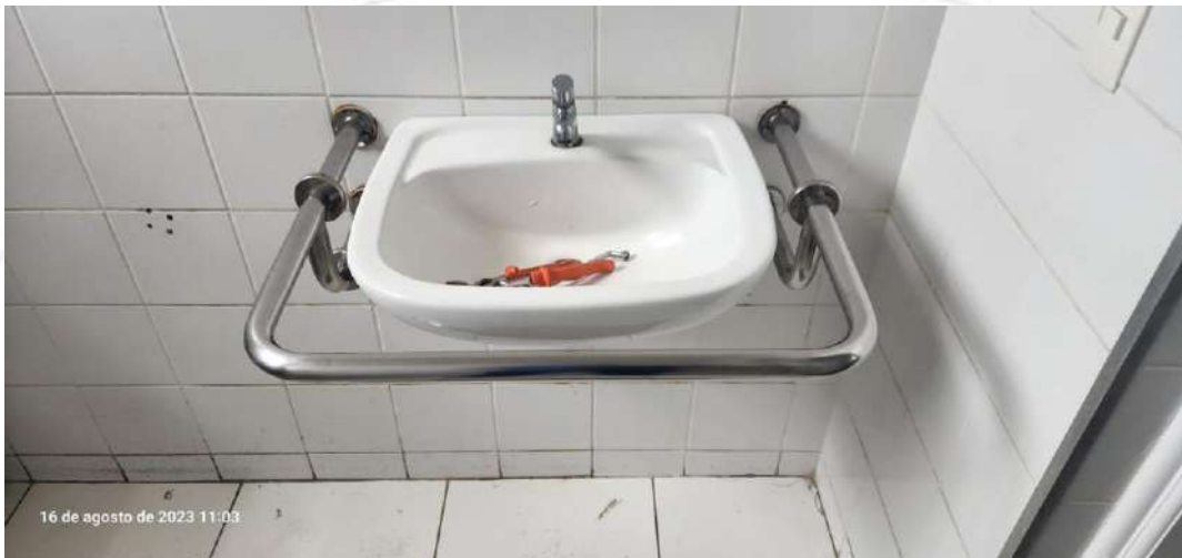
FOTO 39. Vista para lavatório a ser trocado, junto como o suporte para acessibilidade.
