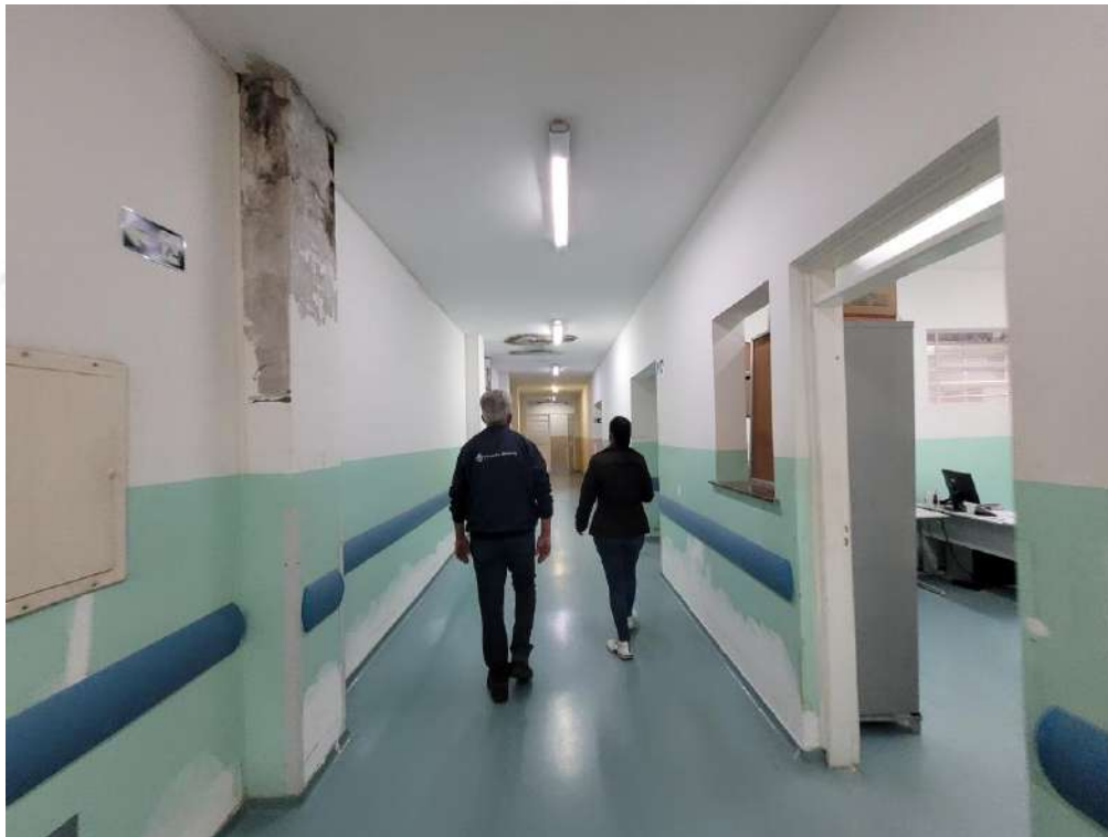
FOTO 5. Vista para o corredor da enfermaria, com manchas de bolor de infiltrações.
