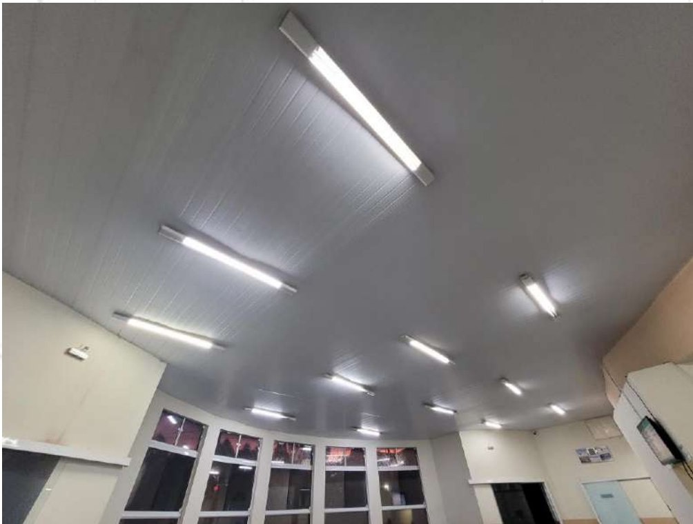
FOTO 22. Vista para troca das lâmpadas danificadas.
